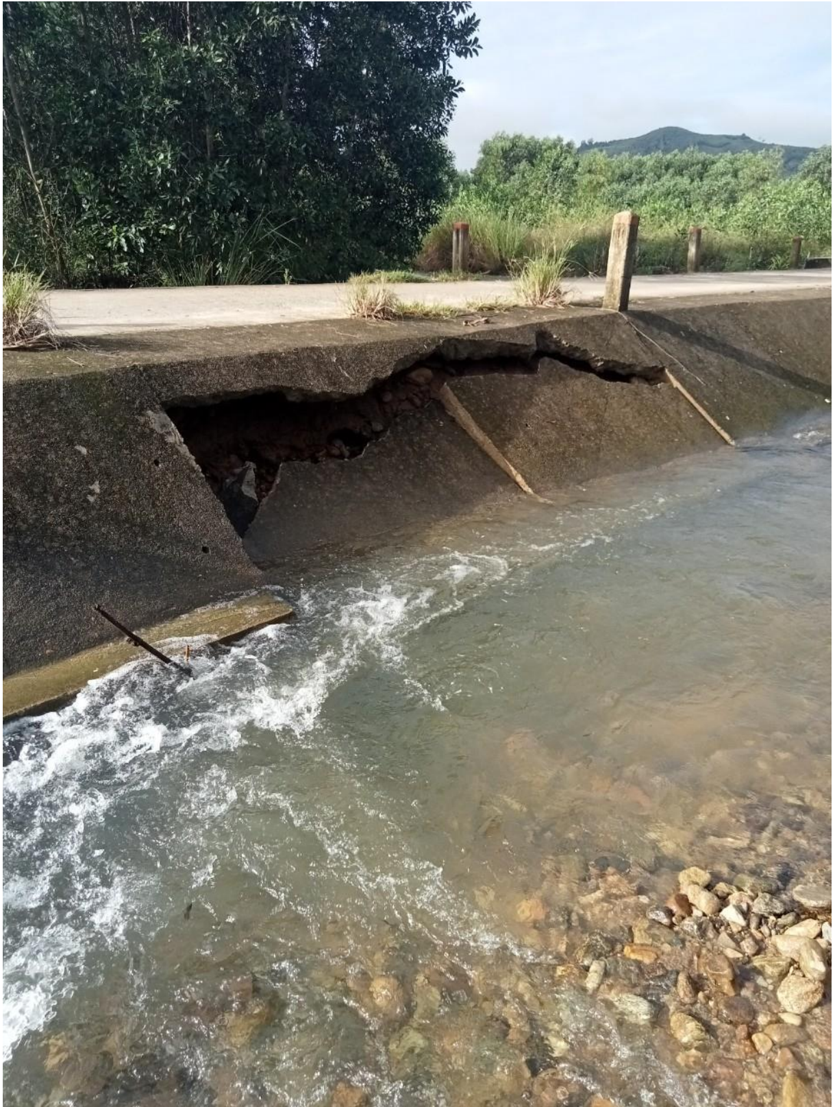
(1). Hình ảnh sạt lở: Tại cống tràn đoạn đường từ thôn Kà Tu đi quan thôn Trường Ka
