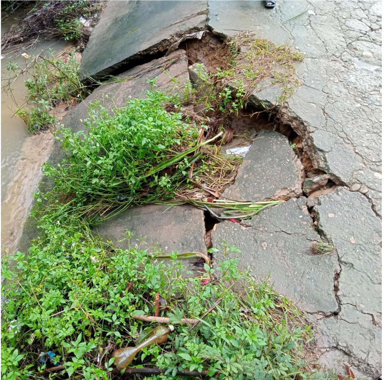
(2). Hình ảnh sạt lở: Tại cống tràn nước Tung, xóm Đèo, thôn Cà Tu
